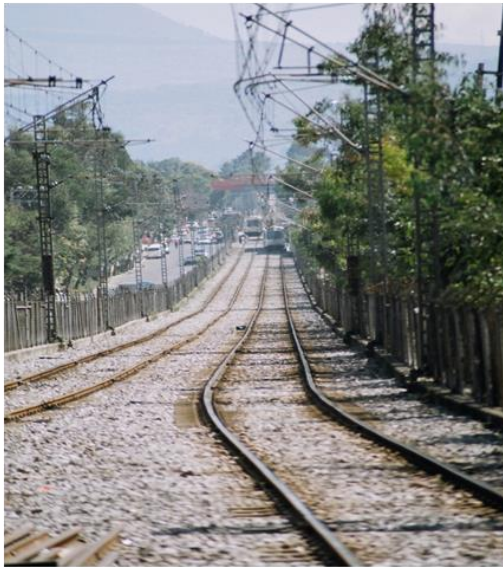
Trazo de la Vía del Tren Ligero en Tramo 2, obsérvese la falta de alineación y nivelación
