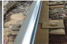
Fijación de la Vía
