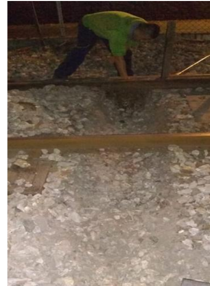
Balasto Contaminado y sin aristas (boleado)
